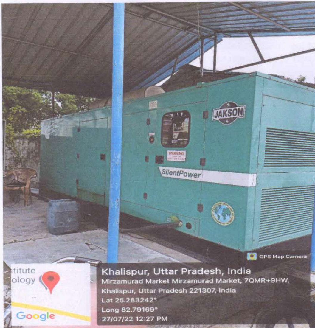
Fig-8.1: DG Set 320 KVA
