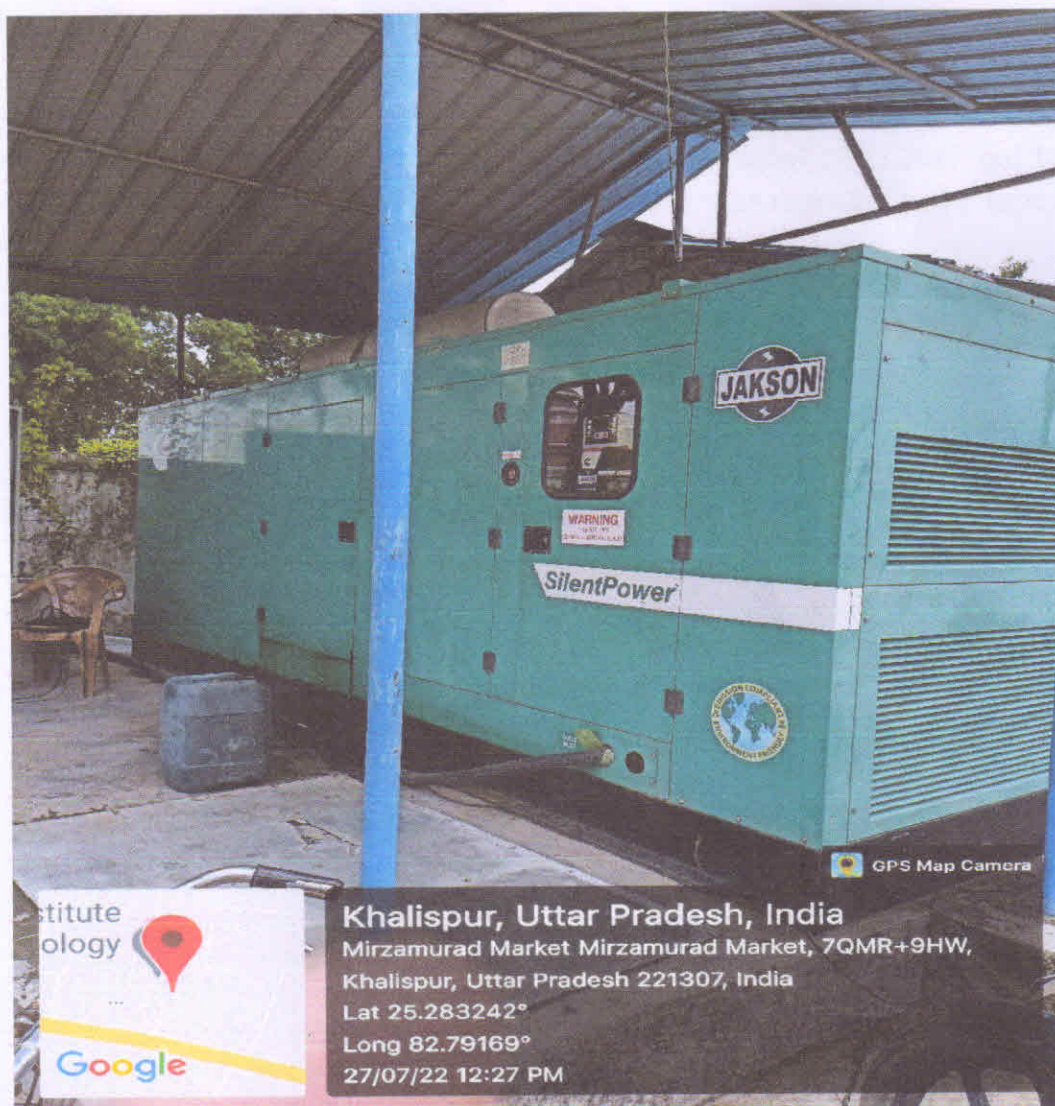
Fig-8.1: DG Set 320 KVA
